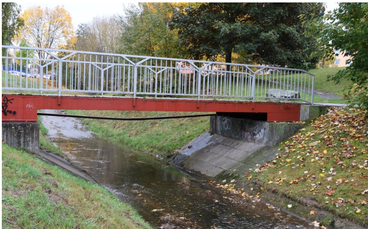
Obrázek 4 - současný stav chátřející lávky
